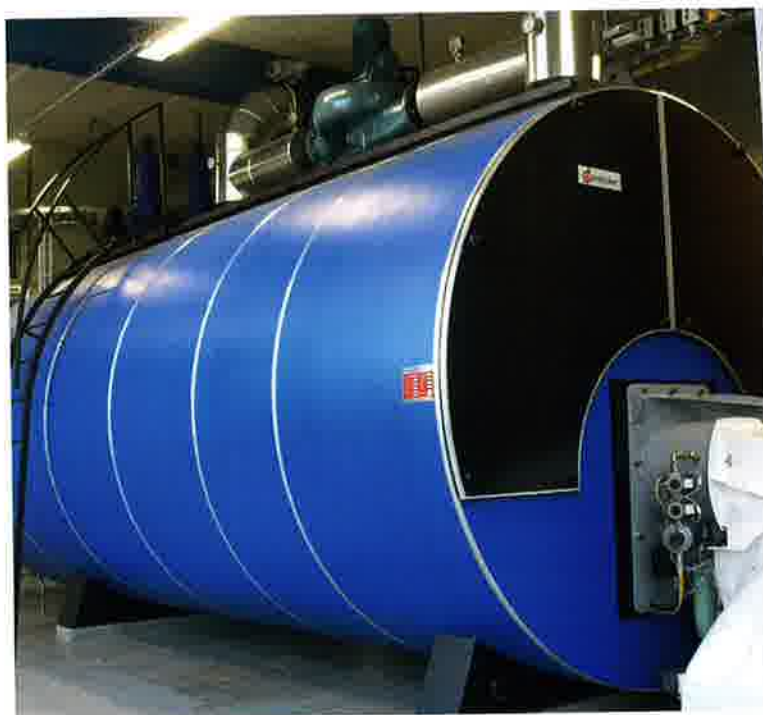
10,4 MW gaskedel installeret i 2005 på Agertoften som reservekedel og tilsluttet nødstrømsanlæg.
