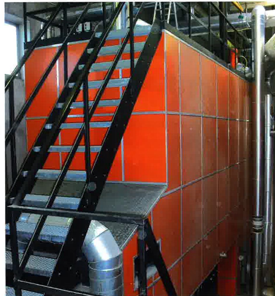
4 MW fliskedel installeret i 2004 i den "tætpakkede" kedelhal på Agertofte.
