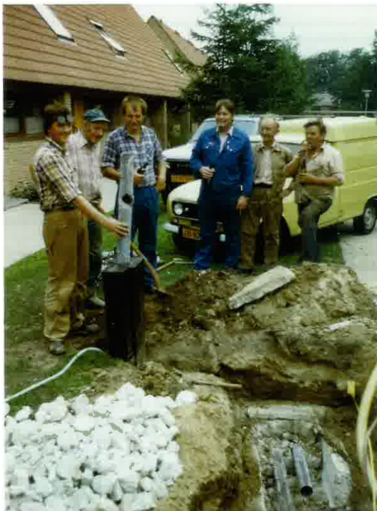
Udbedring af rørskade i 1986 på Banestien ved Jernbanegade forårsaget af en jordrakete.
